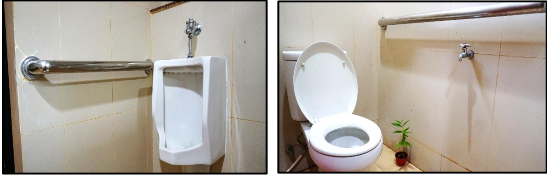
Toilet yang dilengkapi dengan Disability Grip
